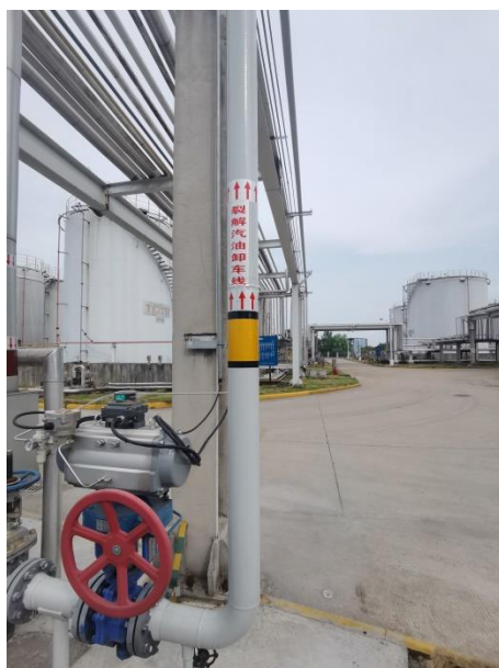
输送管道切断阀
