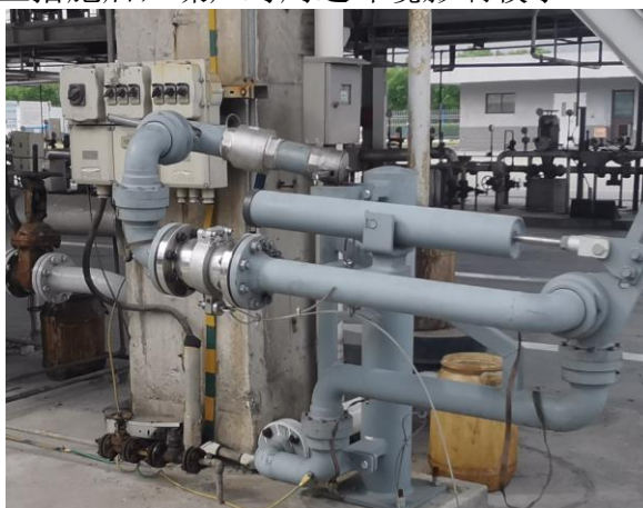
管道与机泵连接处
